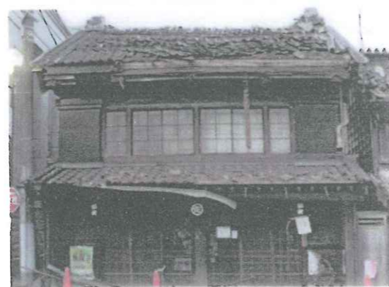
福新呉服店の被害状況
