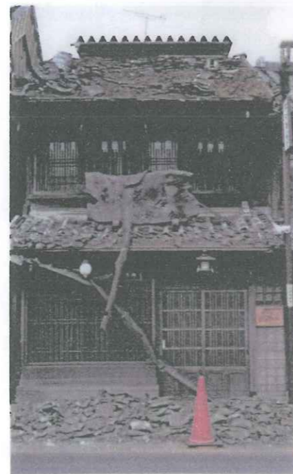
小堀屋本店の被害状況
