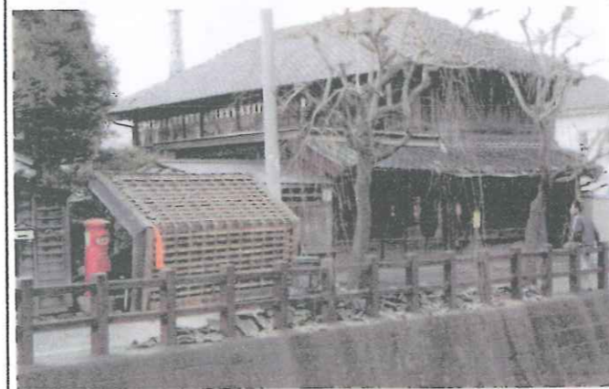
旧東海酒造の被害状況
