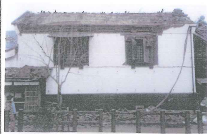
植田屋土蔵の被害状況
